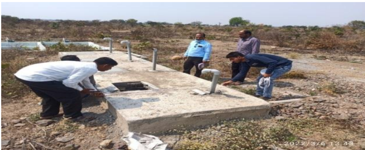
FSTP Plant M.C. Barshitakli
